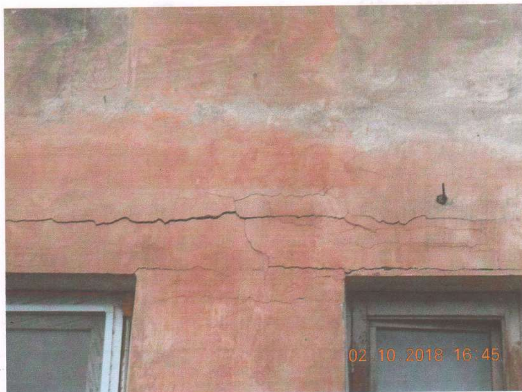
Фото №7. Трещины в несущих стенах
