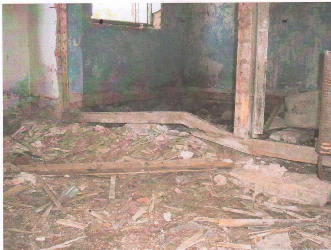
Фото №14. Стены, пол.
